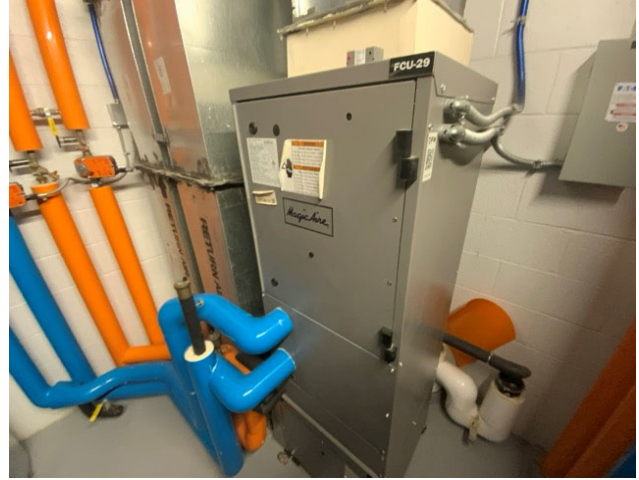
20 - FAN COIL UNIT
